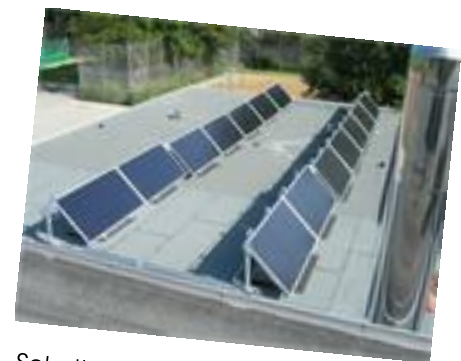
Solarthermieanlage des HSC
